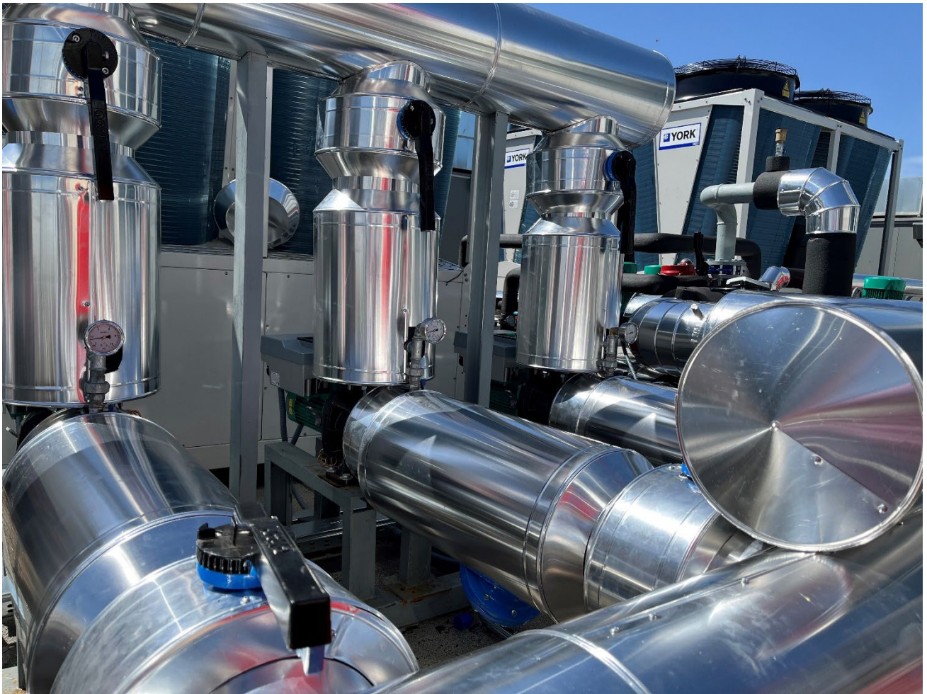
Ilustración 5: Tuberías de distribución y valvulería
