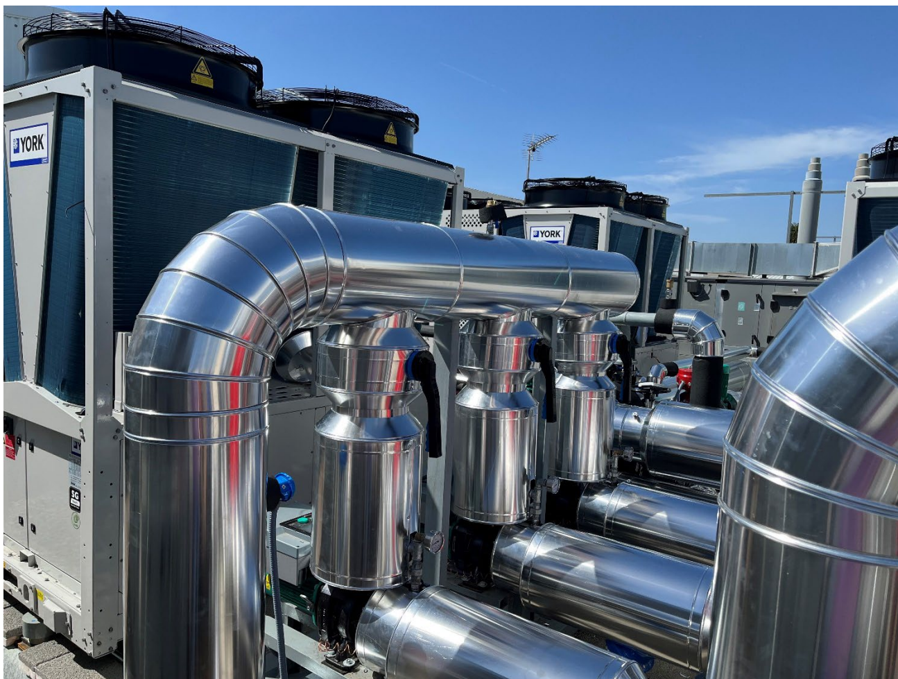
Ilustración 3: Tubería de distribución, valvulería y máquinas al fondo
