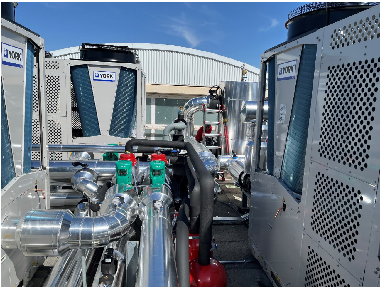
Ilustración 4: Tuberías de distribución y bombas de primario
