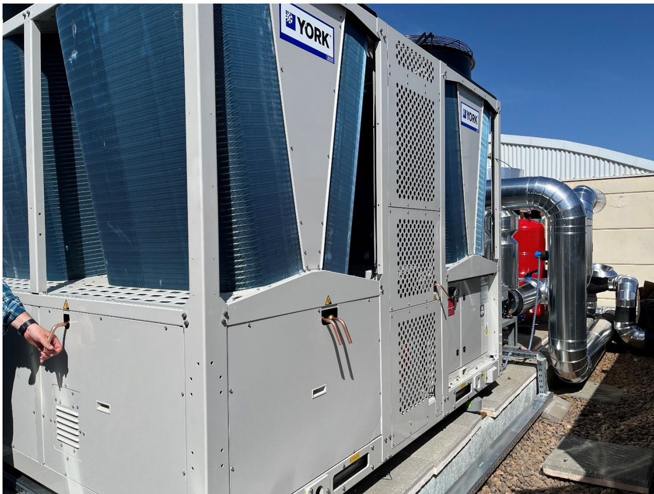
Ilustración 2: Bombas de Calor instaladas
