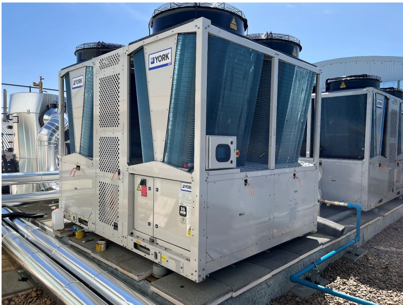
Ilustración 1: Bombas de Calor instaladas
