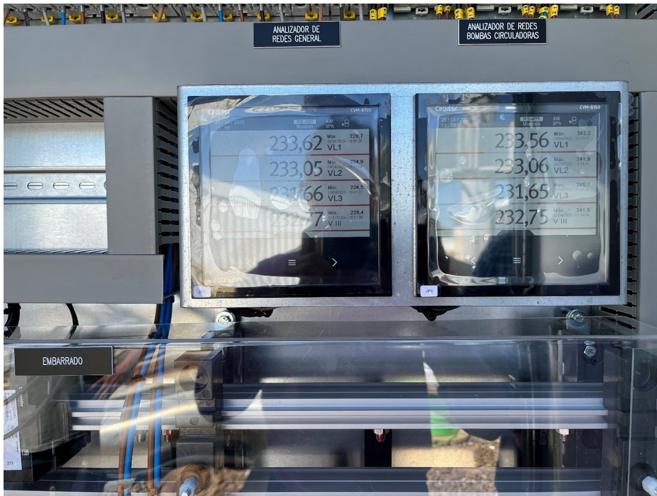
Ilustración 8: Detalle del Cuadro Eléctrico, analizadores de redes
